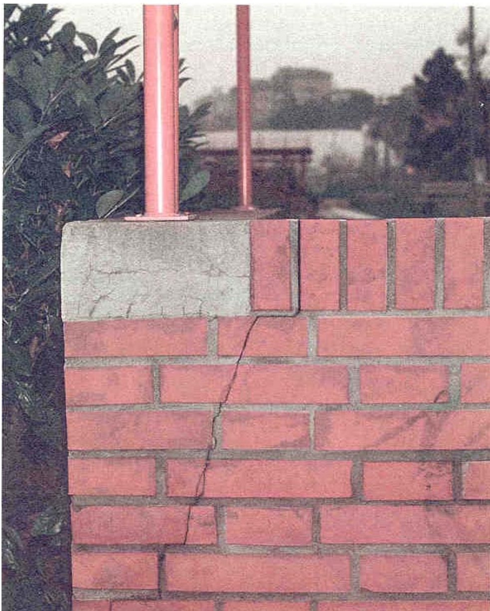
Fig.17 – Lesione dovuta alle deformazioni del muro e del corrimano metallico.
