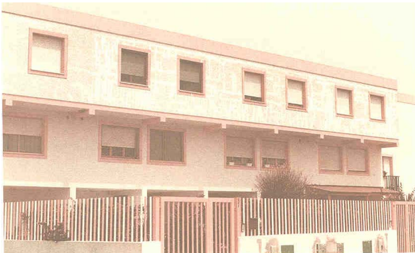
Fig.7 – Intonaci fessurati per eccessivo soleggiamento (al primo piano) e integri (al piano terreno) perché protetti dallo sporto.
