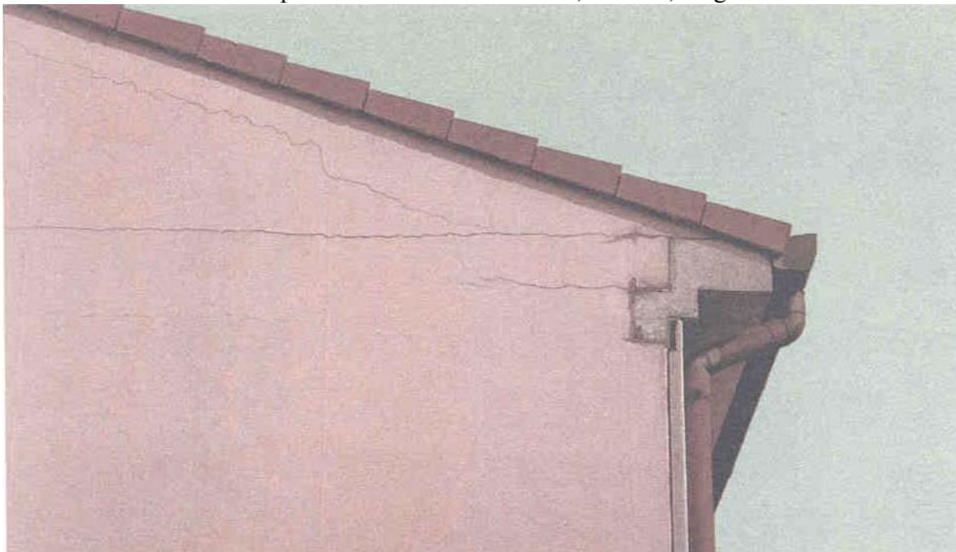
Fig.3 – La fessurazione dovuta alla rotazione del solaio.
