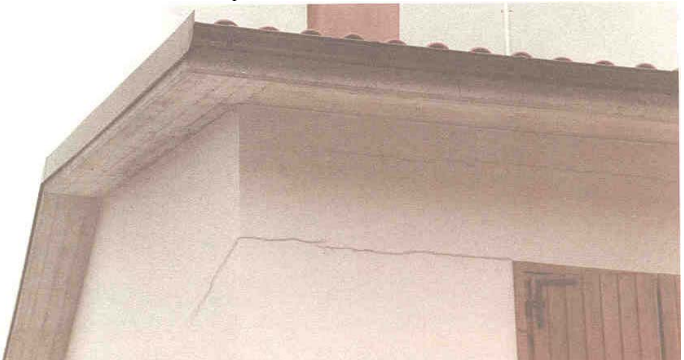
Fig.5 – La fessurazione nell'angolo e in prossimità dello sporto in calcestruzzo
